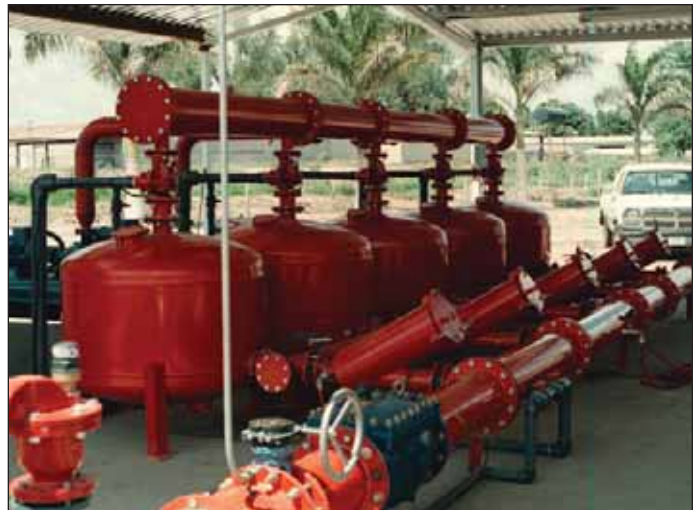
Figura 13. Equipo de filtración.
