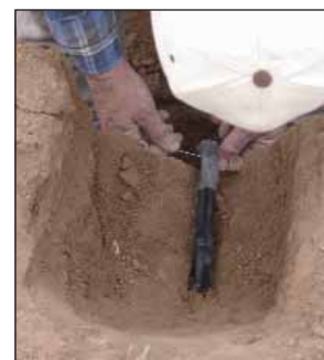
Figura 8. Conexión de la cinta de goteo a la tubería distribuidora.
